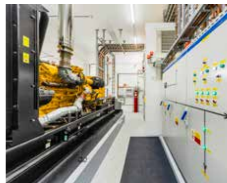
Obr. 5 Technologická místnost s náhradním zdrojem
